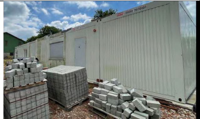
Bild 4: Container für Büro-, Sanitär- und Sozialräumen.
